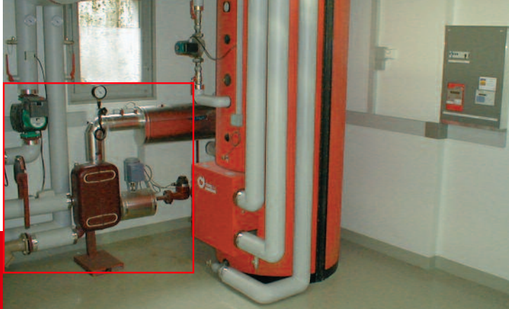
Exemple d'une sous-station de chauffage à distance: petit, simple et propre!
